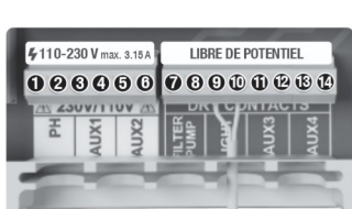
LIGHT Commande éclairage 9 et 10
